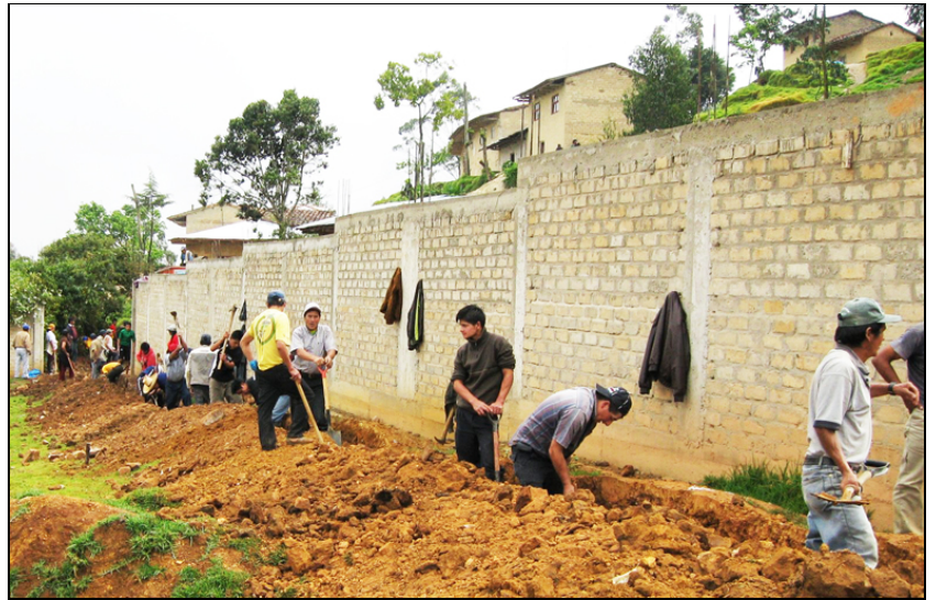
« ...Grâce au don d'un bienfaiteur et au travail bénévole des pères de famille on a déjà levé 250 mètres (du mur périphérique qui délimitera le terrain de 14 000 mètres carrés). Mais il en reste encore 250 mètres à construire. »
