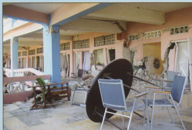
Vue d'un angle de la galerie du 2 e étage : poutres disloquées, murs lézardés, portes et fenêtres cassées...
