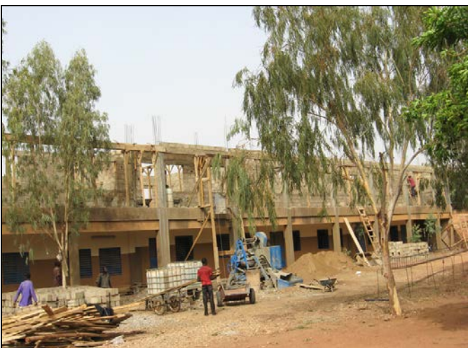
« ... Simultanément, les ouvriers ajoutent un étage au pavillon du primaire qui comptera ainsi de nouveaux locaux de classes. »
